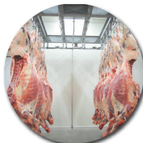
Cavas de Refrigeración
